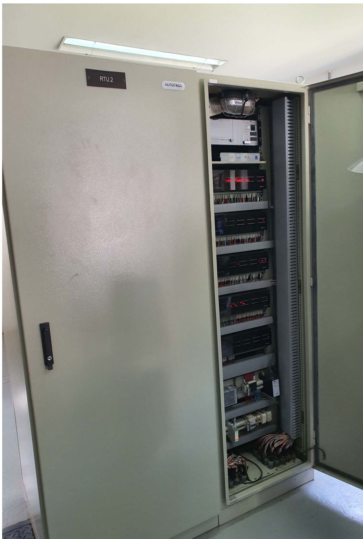
Sala de Control. UTR
