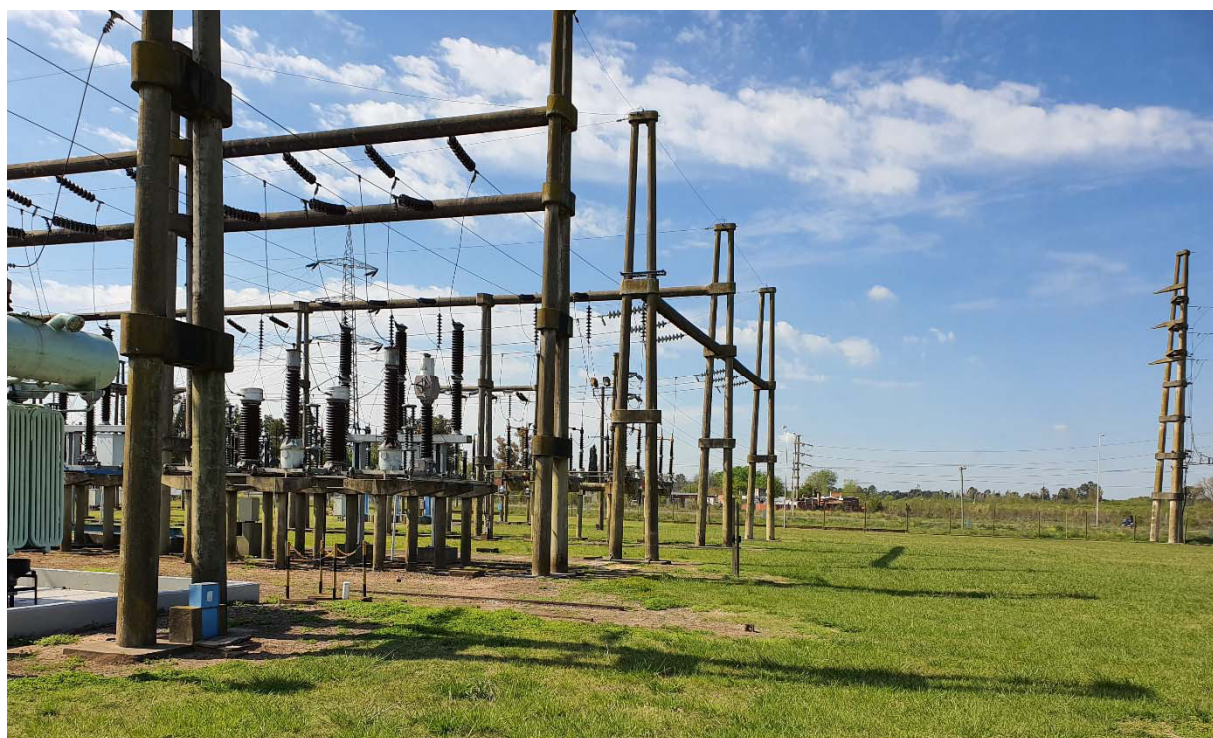
Playa de 132 kV. Previsión de espacio para campo de línea
