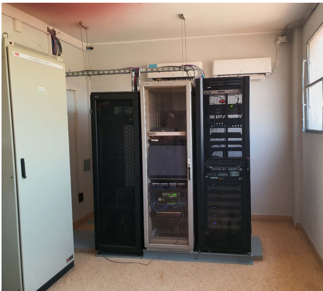
Sala de Comunicaciones
