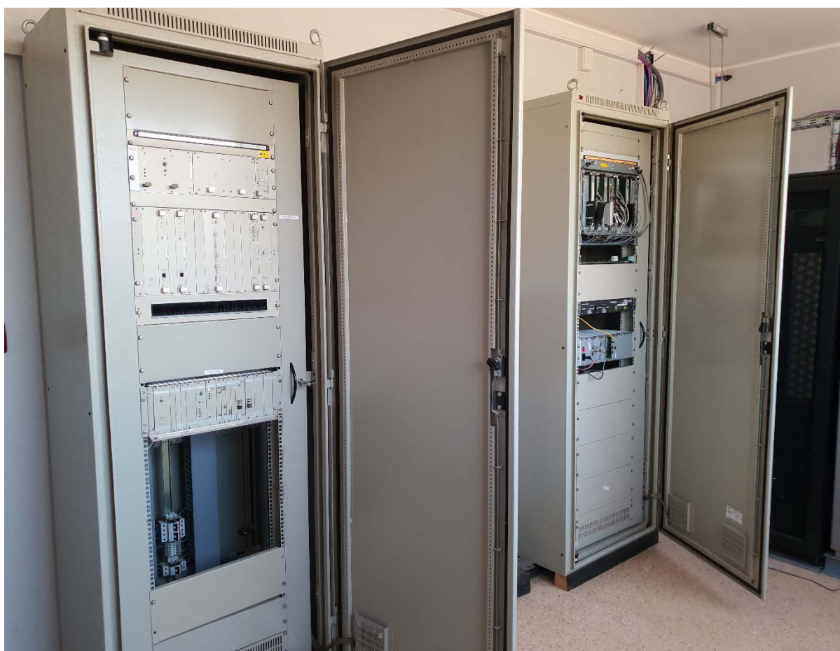
Sala de Comunicaciones
