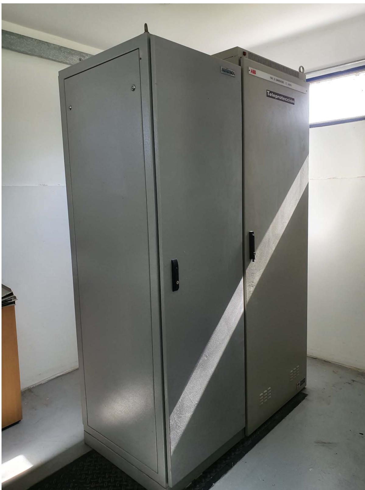
Sala de Comunicaciones. Tablero de Teleprotección
