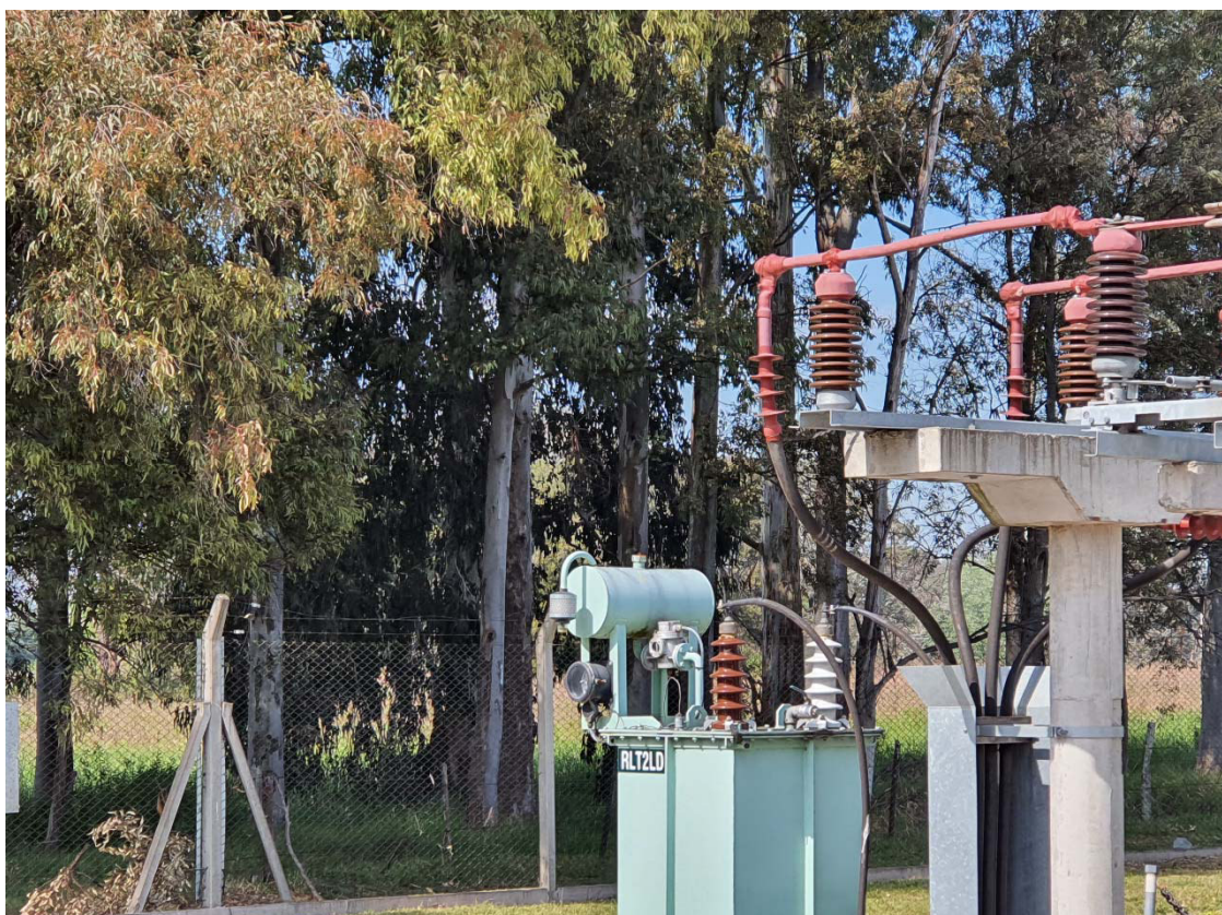
Playa de 132 kV. Cerco perimetral y cortina exterior eucaliptos
