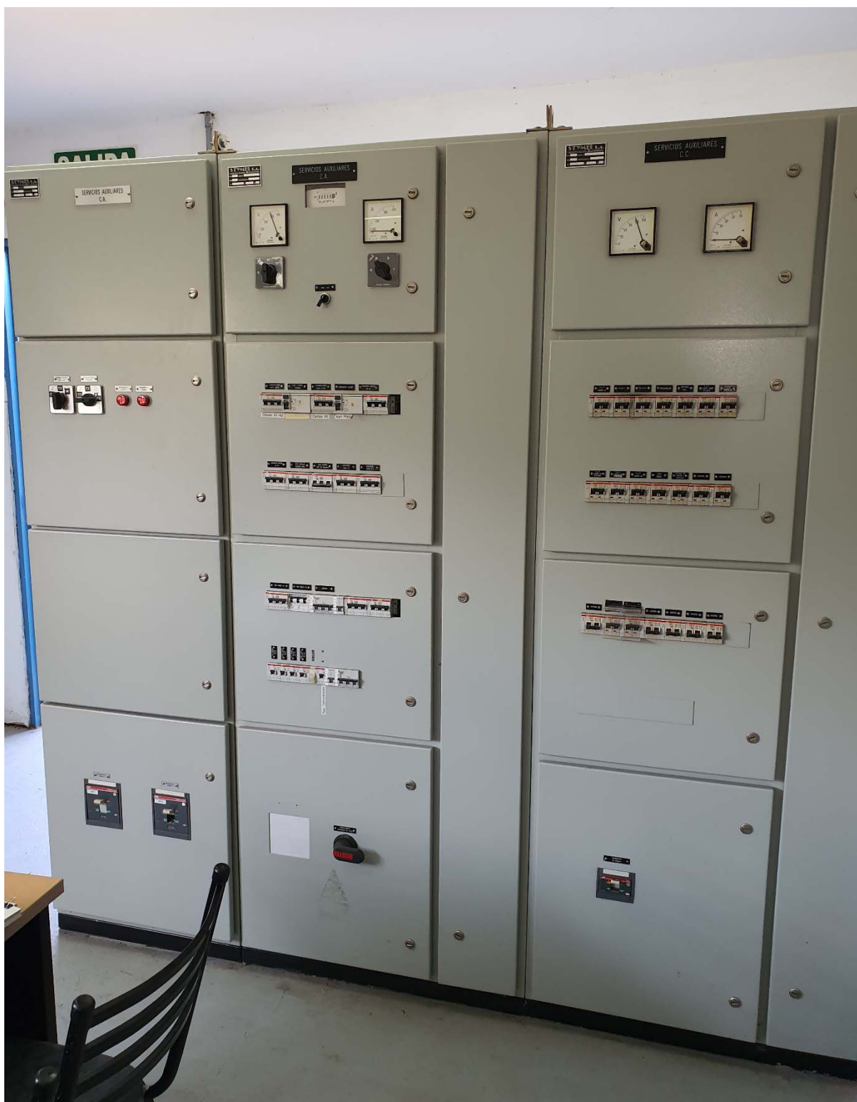
Sala de Control. Tablero Servicios Auxiliares
