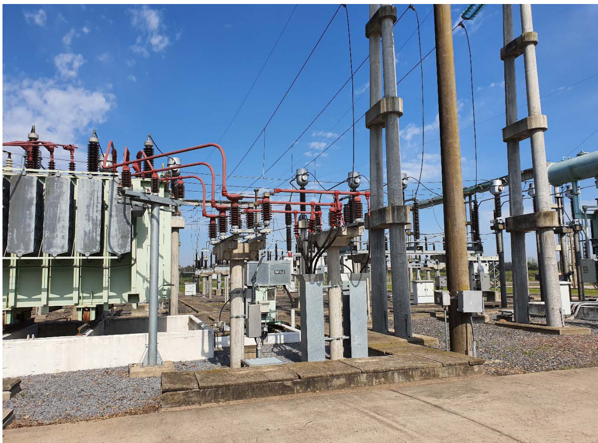
Playa de 132 kV. Vista típica y tipología constructiva (campo de transformador)
