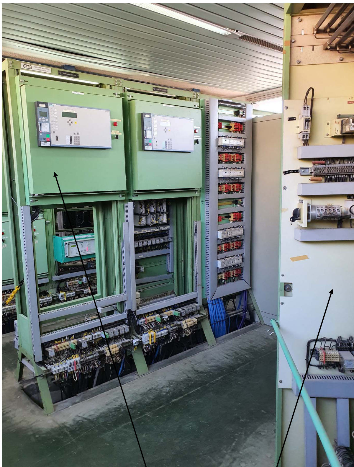
Panel de Protecciones Salida LAT 132 kV a E.T. Luján
